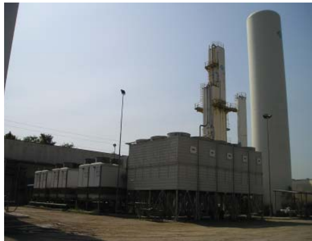
Torri di raffreddamento in serie in un sito industriale
